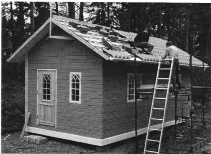
Enkupigt tegel läggs på taket till "den historiska nyckelharpverkstaden". Ola Jansson längst upp på taket och Sven Hessel står på ställningen.
